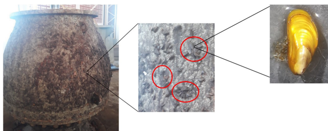
Figura 2. Incrustação de mexilhão-dourado no crivo de bomba da Estação Elevatória que abastece o Canal do Sertão de Alagoas
