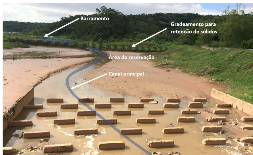
Figura 3 - Reservatório de retenção tipo in line na bacia do Córrego Aricanduva. Fonte: Dos autores.
